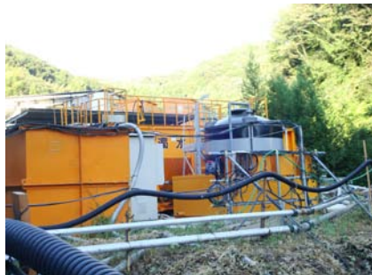
写真 1：水質浄化装置
