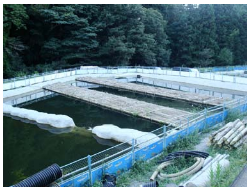
写真 2：沈殿池 1・2 層目のようす
