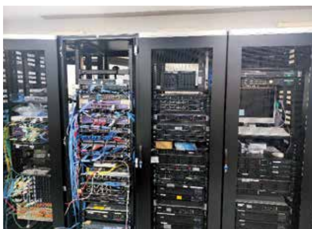
サーバ室に設置された基幹サーバやネットワーク機器
