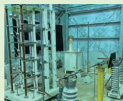
高電圧試験装置
