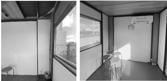
写真4 天井の剥離（左）と設備（右）
